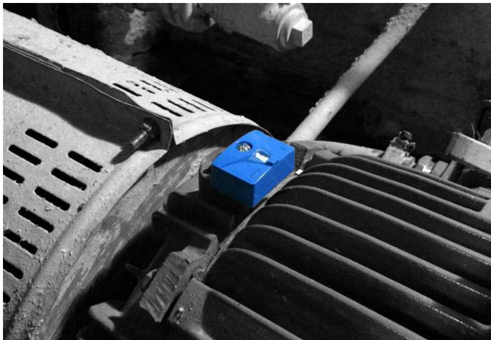
Figura 15: Motor horizontal, instalado en la caja de rodamientos lado acople
